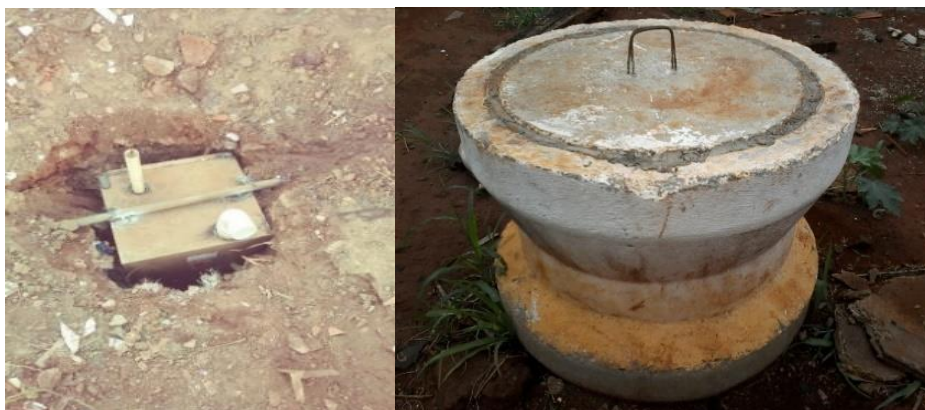
Imagem 9 – Fossa séptica individual e sistema de esgoto sanitário coletivo na Cidade Locomotiva (Ribeirão Preto/SP)
